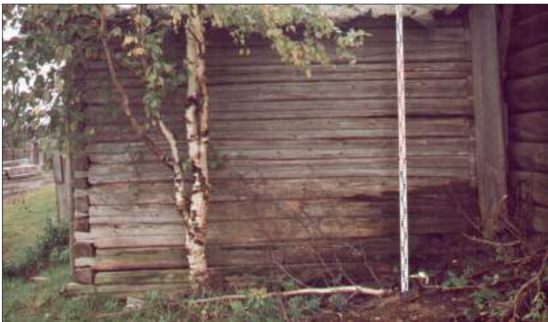
Рис. 24. ХМАО-Югра. Сургутский район, пос. Сайгатино. Дом Махневой (Очимкиной). Фрагмент северного фасада. Прируб. Сильное гниение нижних венцов прируба вызвано плохой организацией водостока и близостью деревьев Fig. 24. KhMAO-Yugra. Surgut District. Saygatino settlement. House of Makhneva (Ochimkina). Fragment of the northern facade. The secondary suite (prirub). Severe rotting of the groundsills of the prirub is caused by poor drainage and the proximity of trees
