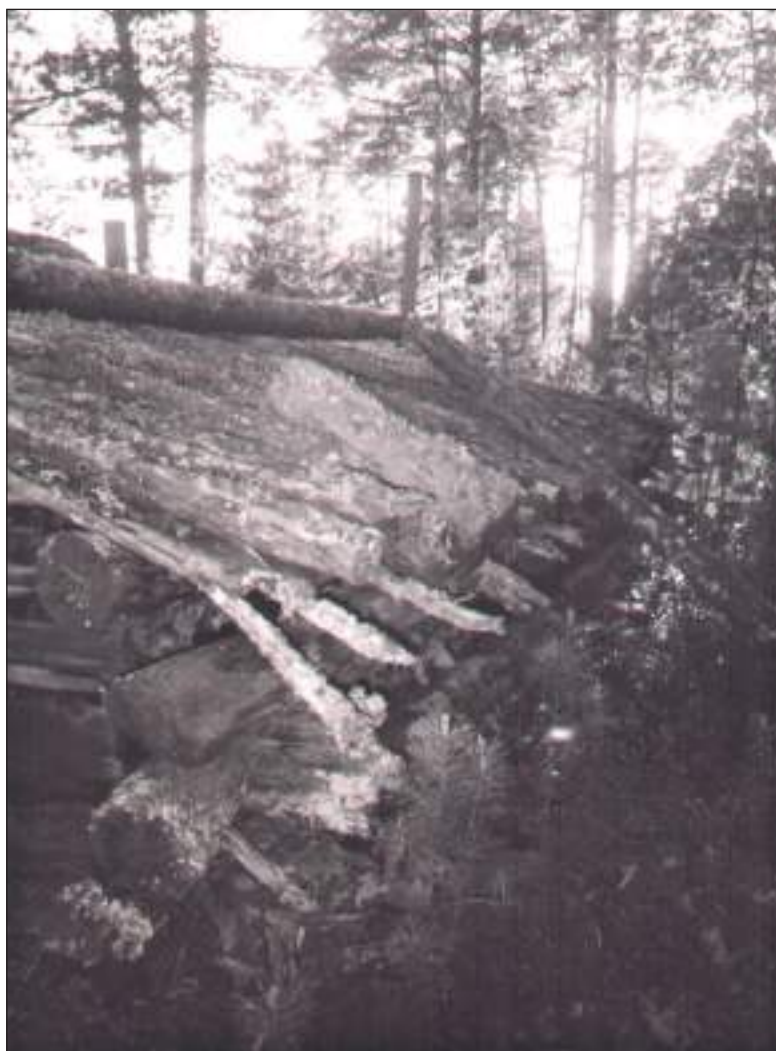
Рис. 96. ХМАО-Югра. Нефтеюганский район, юрты Пунси. Рыбачья изба А. Д. Каюкова. Вид с юго-запада. Аварийное состояние западной стены избы
